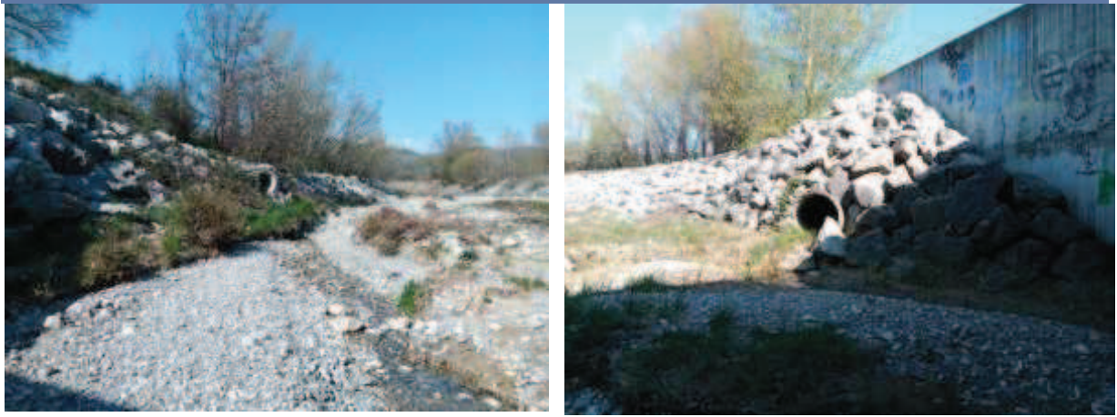
Figure 6 : Exutoire pluvial DN 1000 en rive droite du ravin du Rouveiret (photo de gauche) et DN 1200 en rive gauche (photo de droite).
