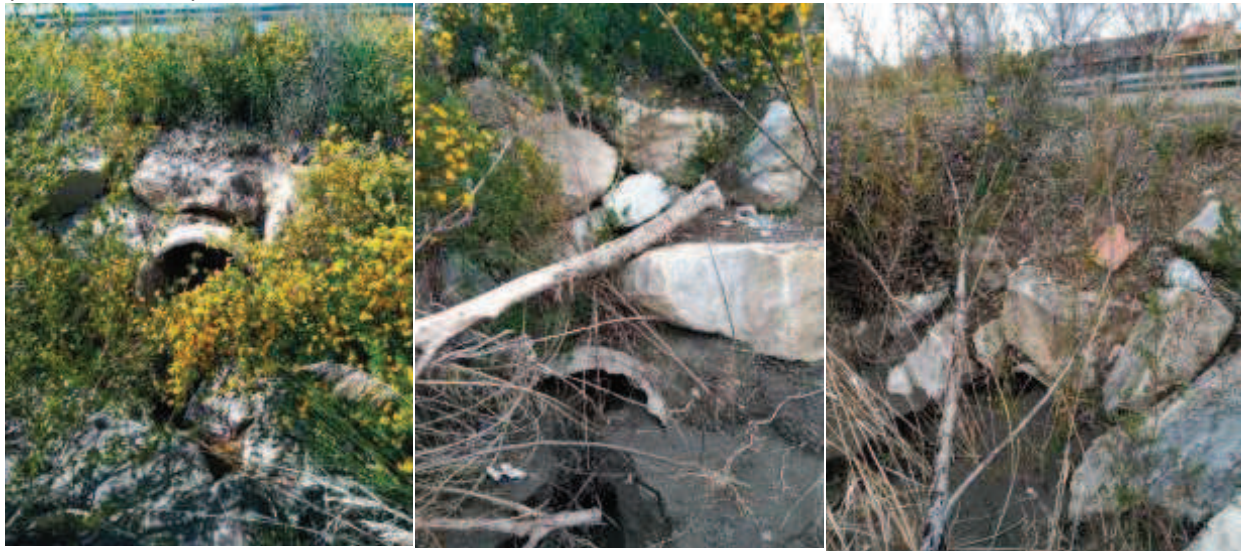
Figure 3 : Vue de la buse DN 800 au linéaire 230m (gauche), de la buse DN 700 au linéaire 470 m (milieu), de la buse DN 600 au linéaire 560 m (droite).
